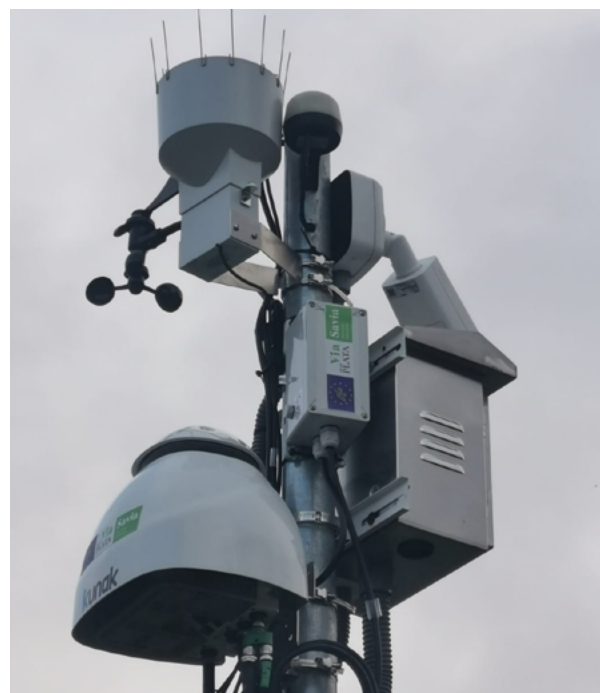
Detalle de una estación MES..
